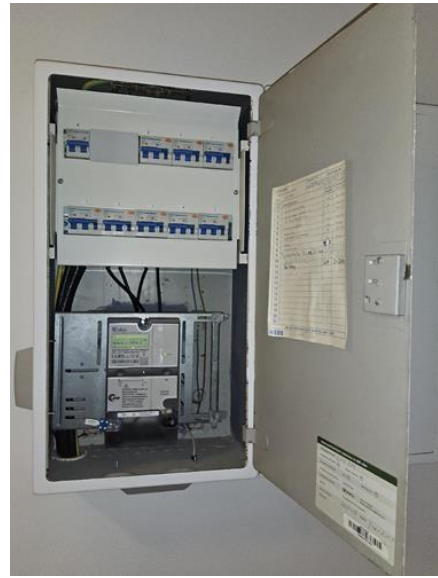
Elektrisk anlegg - [Sikringskap i fellesgang.]
