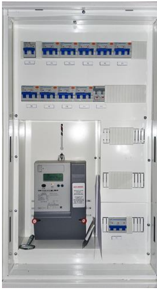
Forenklet vurdering av det elektriske anlegget - [Sikringskap]
