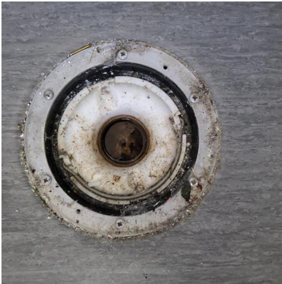
Avløpsrør (ink. sluk) - [Sluk vaskerom ]
