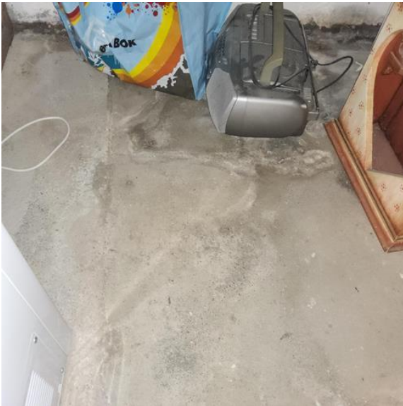
Innvendig - [Eksempel på fuktmerker, salt-/kalkutslag i kjellerbod]
