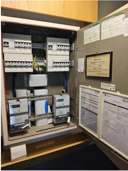
Elektrisk anlegg - [Sikringskap. ]
