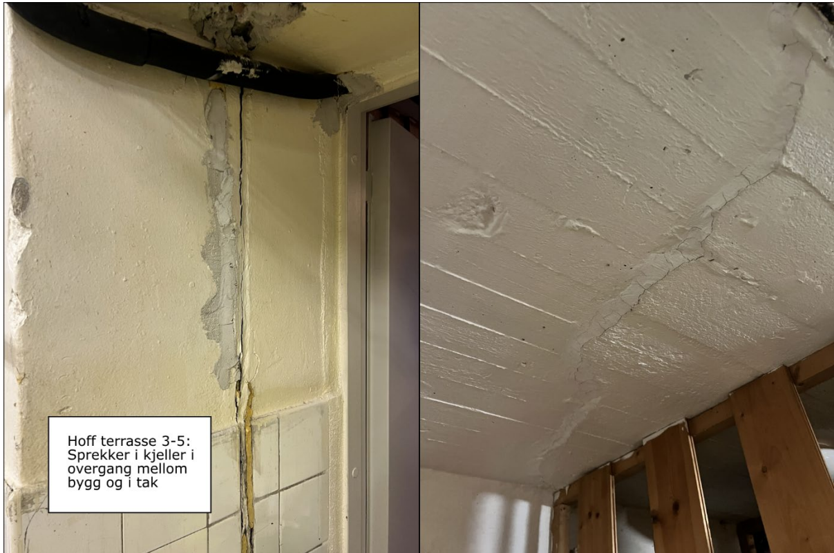
Figur 6-3. Setningsskader i kjeller, Hoff terrasse 3-5
