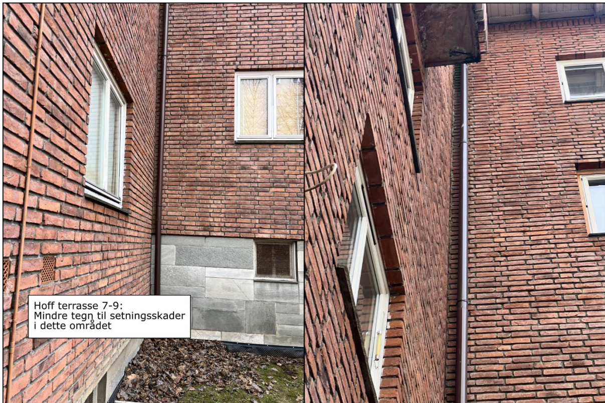
Figur 6-5. Østre hjørne mellom nr. 7 og 9. Her er det mindre tegn til setningsskader.
