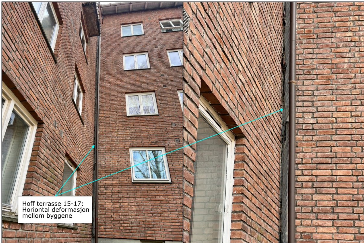
Figur 6-6. Horisontale deformasjoner mellom nr. 15 og 17.
