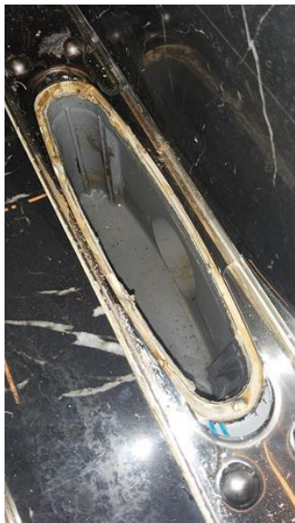
Avløpsrør (ink. sluk) - [Sluk 1 bad 2. etasje]
