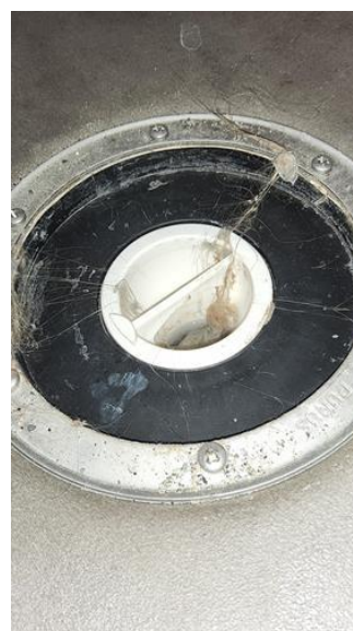
Avløpsrør (ink. sluk) - [Sluk bad leilighet]
