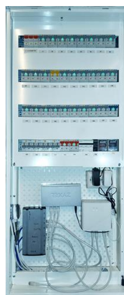
Forenklet vurdering av det elektriske anlegget - [Sikringskap i omkleddingsrom]
