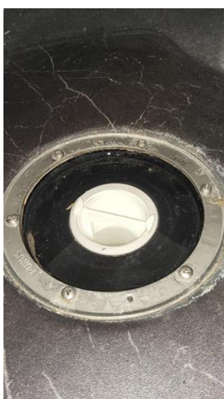
Avløpsrør (ink. sluk) - [Sluk vaskerom]
