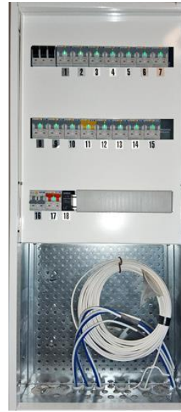
Forenklet vurdering av det elektriske anlegget - [Sikringsskap leilighet]
