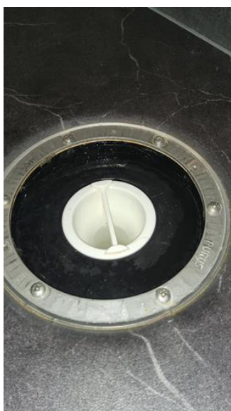
Avløpsrør (ink. sluk) - [Sluk bad 1. etasje]
