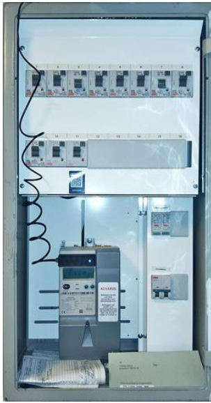
Forenklet vurdering av det elektriske anlegget - [Sikringskap]
