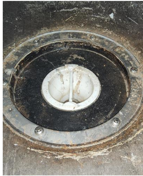
Avløpsrør (ink. sluk) - [Sluk vaskerom]
