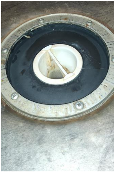
Avløpsrør (ink. sluk) - [Sluk bad]
