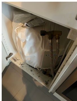
Varmtvannsbereder etablert i kjøkkenskap i hybeldel.
