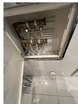
Samlestokk i vegg i bad 1 i kjeller.
