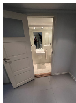
Malt heltre fyllingsdør med glassparti til bad i kjeller fra 2011.
