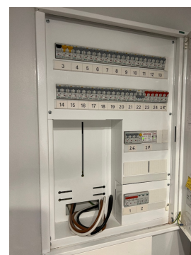
Hoved el. skap etablert i vaskerom.
