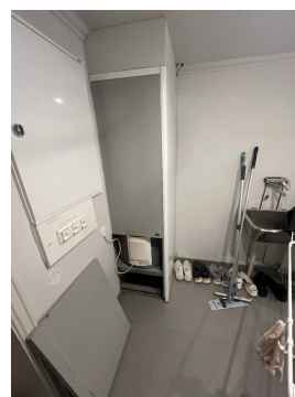
Varmtvannsbereider etablert i skap på vaskerom.
