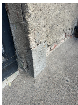
Typisk lokal skade på puss i overgang balkongdekke/ fasade, samt parti ved murverkslist rundt døråpning.
