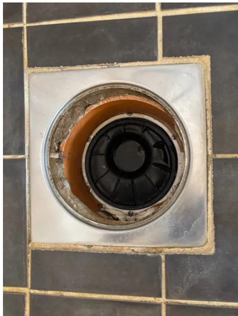
Baderomssluk plassert i dusjsone.
