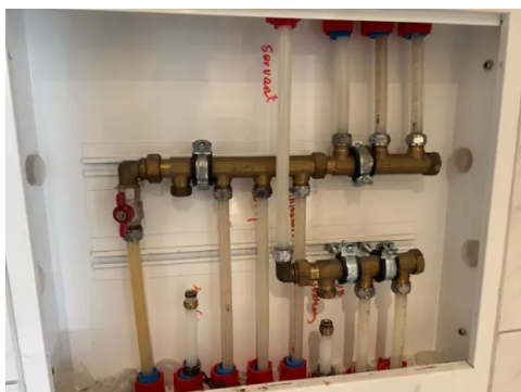
Rørfordelerskap plassert i vegg på bad/vaskerom.
