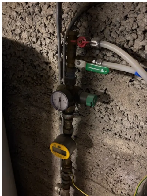
Vannmåler og stoppekran synlig plassert i rom i kjelleren.
