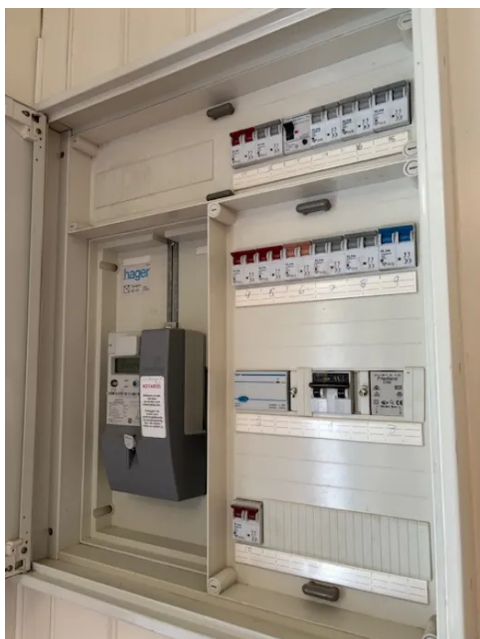
Sikringsskap med automatsikringer plassert i entre/gang.
