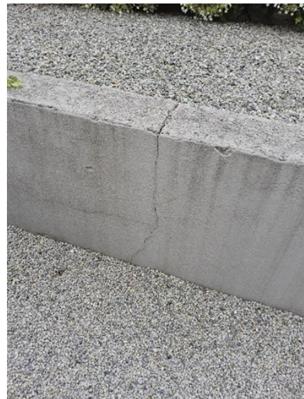
Forstøtningsmurer - [Sprekk i forstøtningsmur.]
