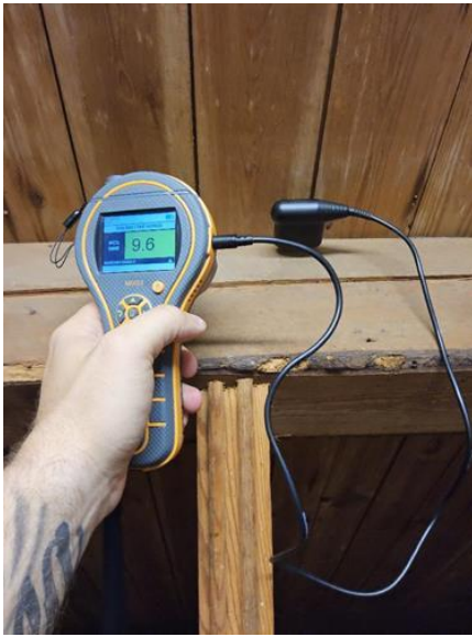
Loft - uinnredet / råloft - [Fuktmåling i takkonstruksjonen.]
