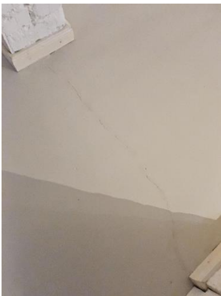
Rom under terreng (kjeller, underetasje, sokkeletasje) - [Sprikk/riss i gulvoverflate mellom kjøkken og kjellerstue (u.etg).]
