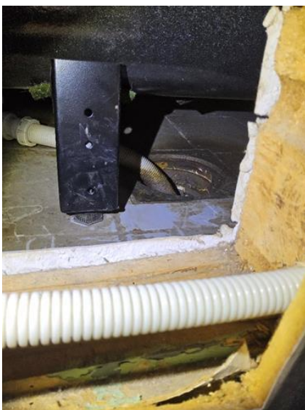
Våtrom - [Sluk på bad 2.etg (under badekar).]
