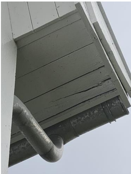
Yttertak - [Råteskader i gesimskasse.]
