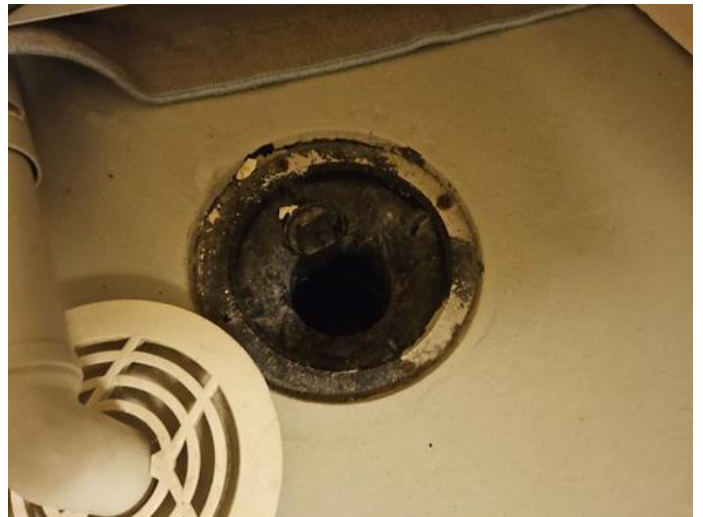
Rom under terreng (kjeller, underetasje, sokkeletasje) - [Sluk i bod u.etg. ]
