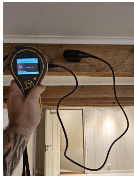
Rom under terreng (kjeller, underetasje, sokkeletasje) - [Fuktmåling i takbjelke.]
