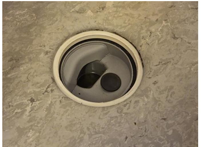
Våtrom - [Sluk på bad u.etg (dusjsonen).]
