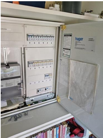
Elektrisk anlegg - [Sikringskap.]
