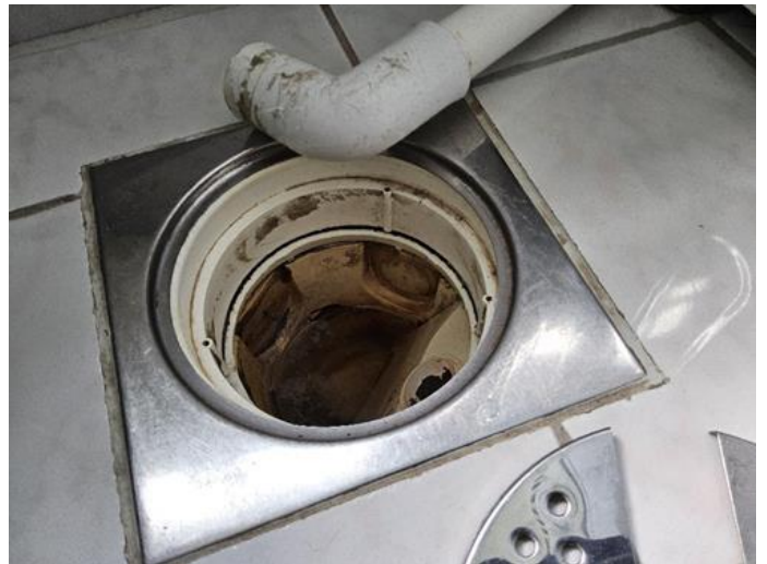
Våtrom - [Sluk bad 2.etg (ved vaskemaskin).]
