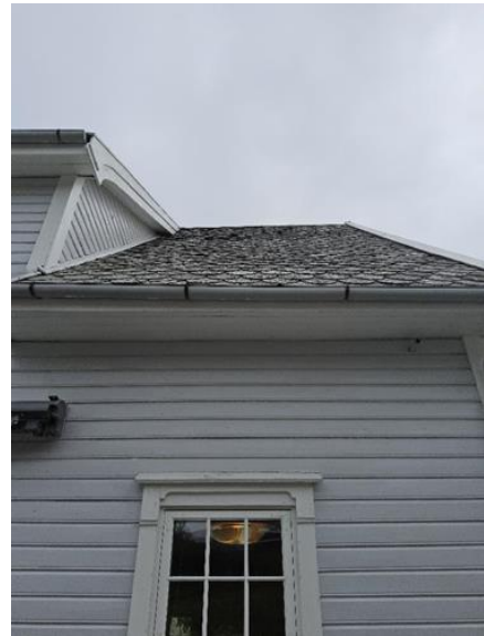
Yttertak - [Skjevheter observert i takkonstruksjonen.]
