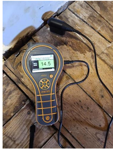
Loft - uinnredet / råloft - [Fuktmåling gulvbord.]
