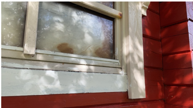
Eksempel på manglende beslagsløsning under vinduer.
