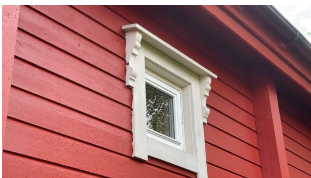
Eksempel på manglende beslagsløsning over vinduer.
