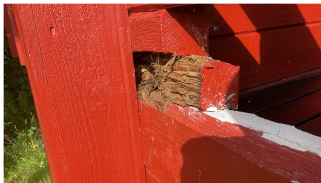
Eksempel på råteskader i knutepunktene på tømmerkonstruksjonen.
