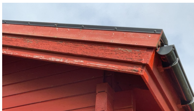
Eksempel på råteskader manglende vedlikehold på vindskier.
