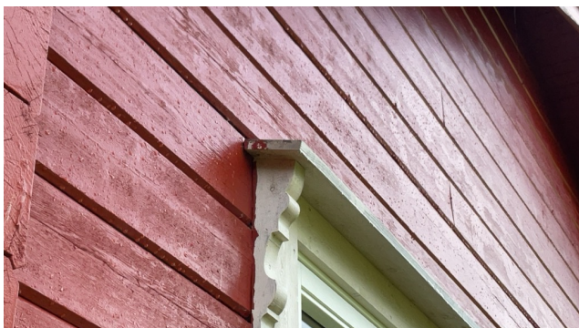
Eksempel på manglende beslagsløsning over vinduer.
