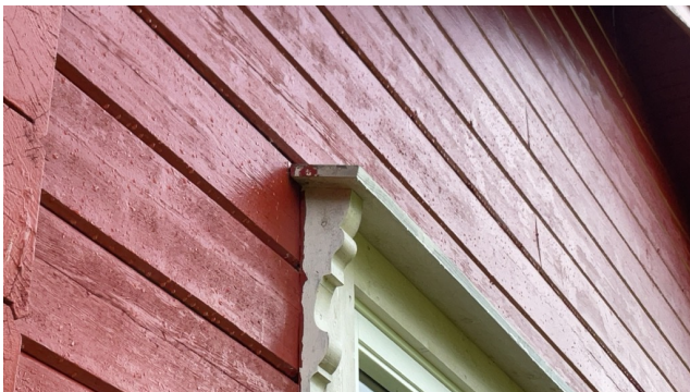
Eksempel på manglende beslagsløsning over vinduer.
