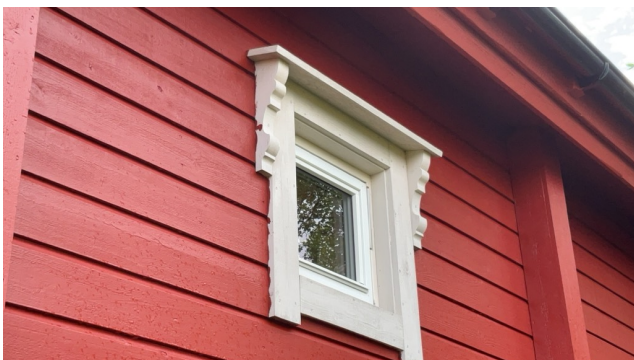
Eksempel på manglende beslagsløsning over vinduer.
