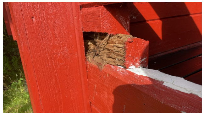
Eksempel på råteskader i knutepunktene på tømmerkonstruksjonen.
