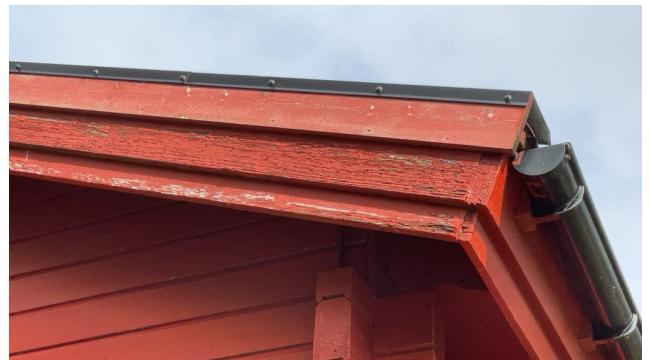
Eksempel på råteskader manglende vedlikehold på vindskier.
