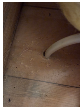
Eksempel på utettheter i dampsperre.
