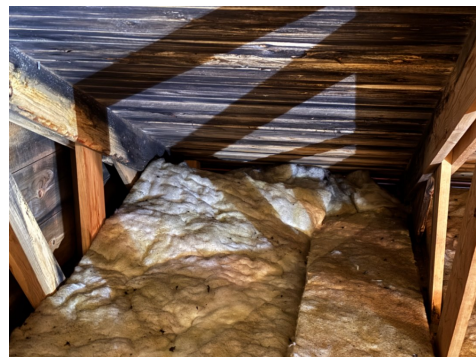
Eksempel på begrenset luftespalte samt stedvis omfattende fuktskjolder og anløp til råteskader i undertak.
