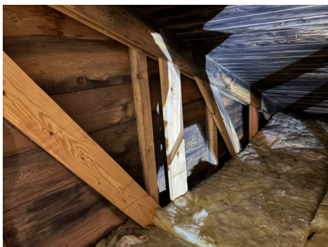
Eksempel på stedvis omfattende fuktskjolder og anløp til råteskader.
