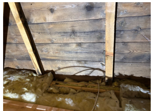
Eksempel på fukt- og råteskader på liggende bordkledning i røstvegger over 1. etg.
