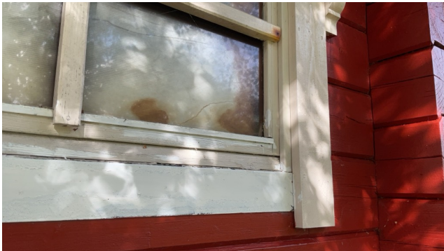
Eksempel på manglende beslagsløsning under vinduer.
