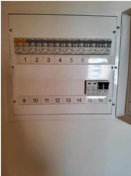
Elektrisk anlegg - [Sikringskap ]
