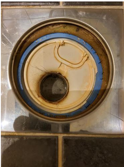
Membran, tettesjikt og overgang til sluk. - [Sluk bad med adkomst fra entré ]
