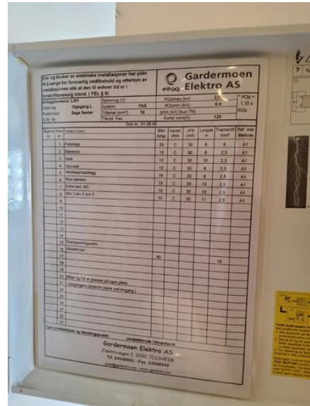
Elektrisk anlegg - [Kursfortegnelse ]
