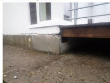
Sprekke er uendret siden utbedringer.
