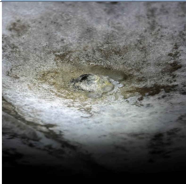
Bilde 20: aktiv lekkasje
