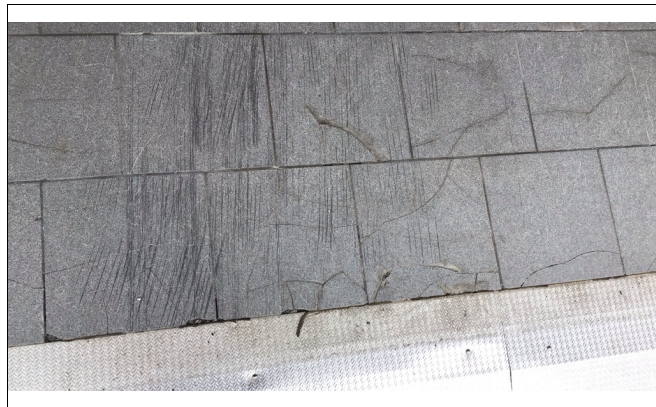
Sprukne fliser i garasje
