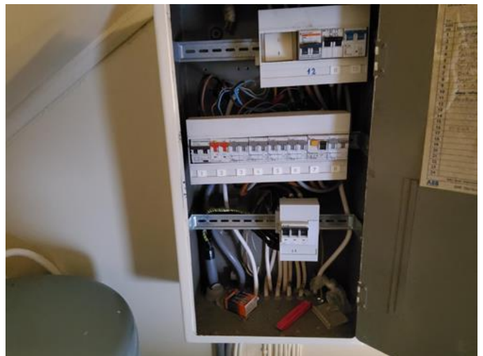
Elektrisk anlegg - [Sikringsskap enebolig.]
