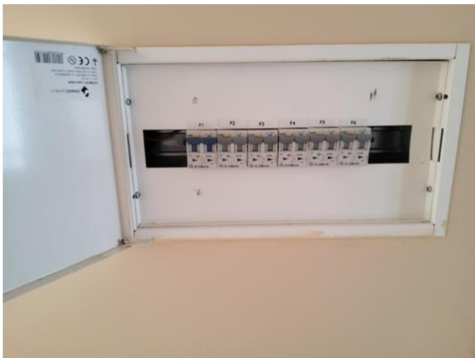
Elektrisk anlegg - [Sikringsskap 2. etg. anneks. ]
