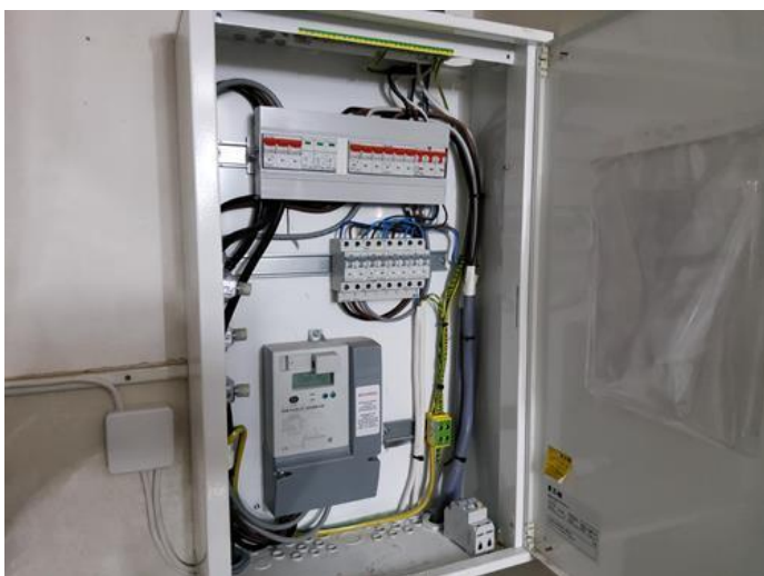
Elektrisk anlegg - [Sikringsskap 1. etg. 4B ]
