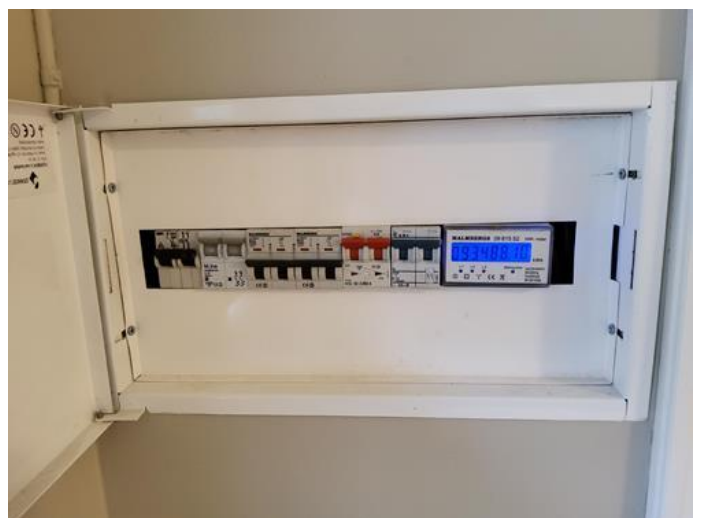
Elektrisk anlegg - [Sikringsskap annek.]
