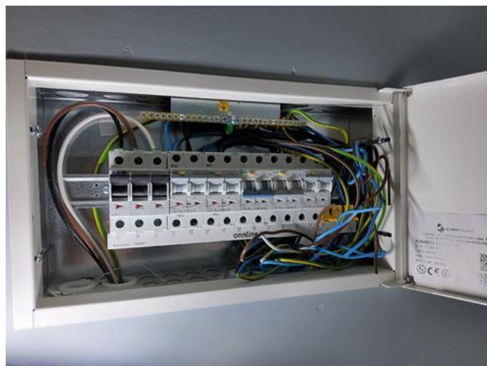
Elektrisk anlegg - [Sikringsskap 2. etg. 4B ]
