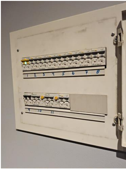
Elektrisk anlegg - [Sikringskap ]
