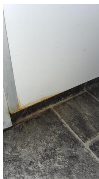
Overflater vegger - [Symptomer på svelleskader i dusjsonen]
