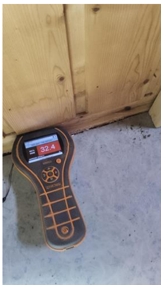
Helhetsvurdering - [Fuktmåling i kjeller]
