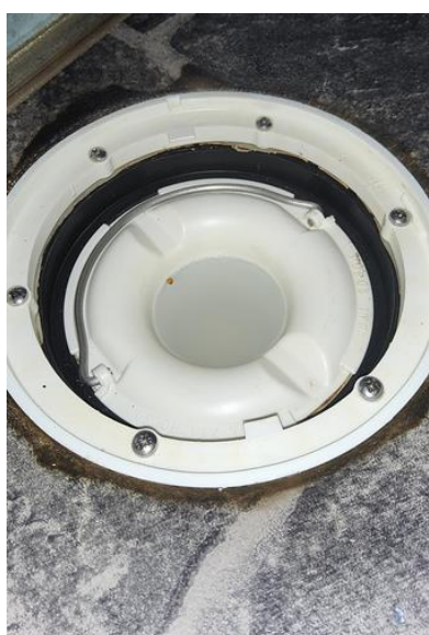
Avløpsrør (ink. sluk) - [Sluk bad]
