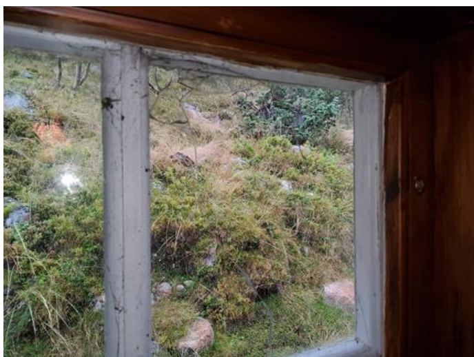
Vinduer - [Sprukket glass]
