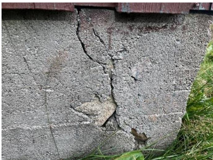
Beskrivelse - [Eksempel på sprekker i grunnmur]
