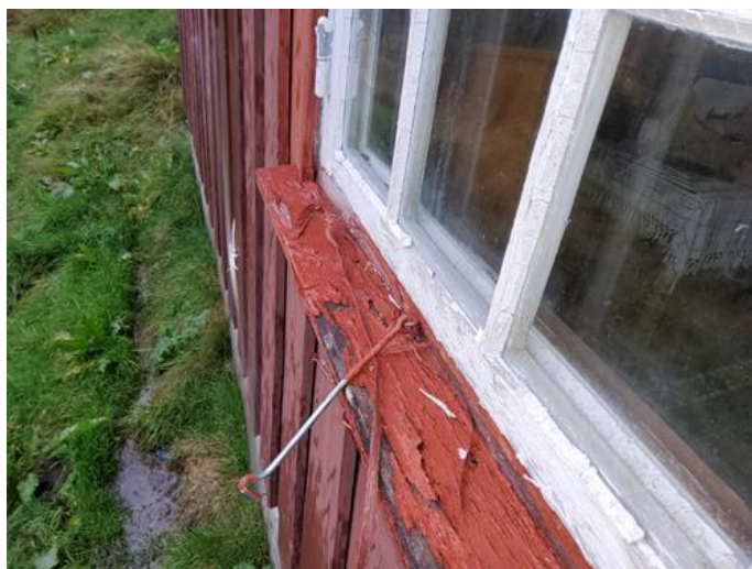
Vinduer - [Eksempel på slitasje]
