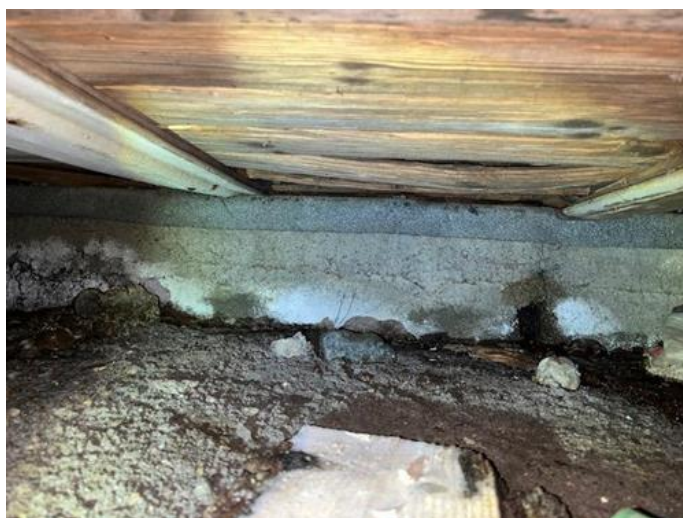
Helhetsvurdering - [Eksempel på råteskader i krypekjeller]
