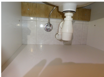
Manglende tetting kring avløpsrøret
