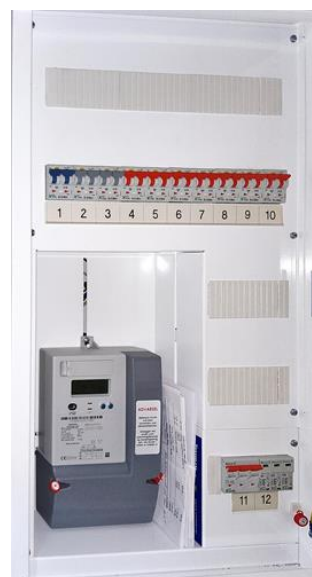
Forenklet vurdering av det elektriske anlegget - [Sikringskap]
