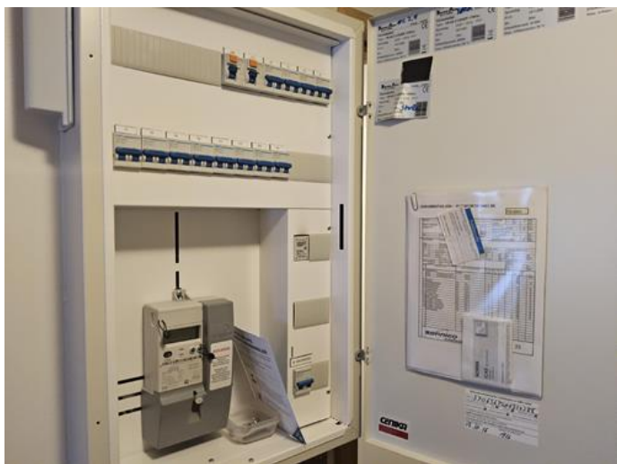
Elektrisk anlegg - [El-skap.]
