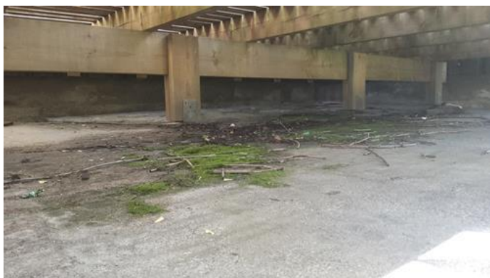
Fundamenter - [Sprekker i plate på mark under terrasse]
