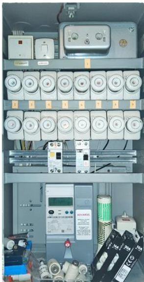
Forenklet vurdering av det elektriske anlegget - [Sikringskap]
