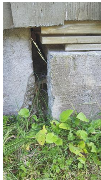
Fundamenter - [Glippe i betongskjøt under terrasse]
