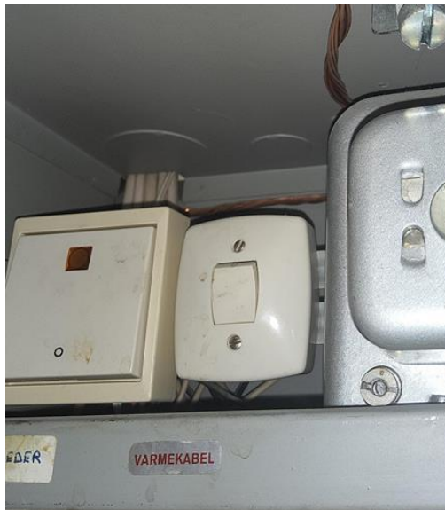
Forenklet vurdering av det elektriske anlegget - [Åpning i sikringskap]
