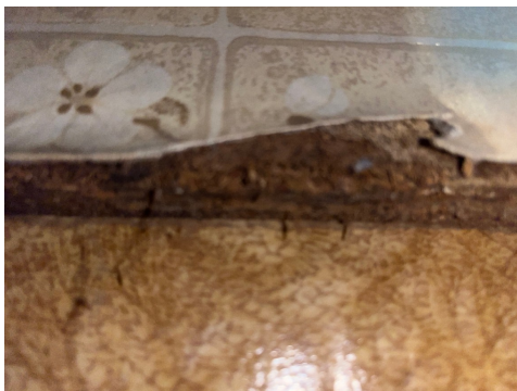
Utett overgang gulv/vegg.
