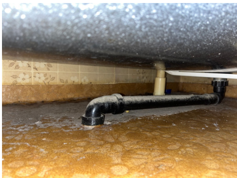
Utett rørgjennomføring gjennom tettesjikt/gulv.
