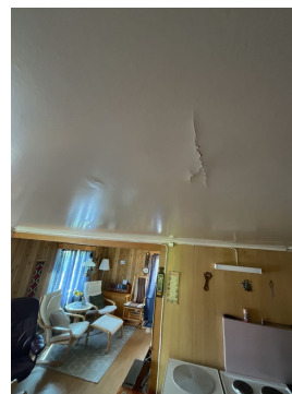
Sprekk i tapet på himling, tapet har løsnet fra underlag.
