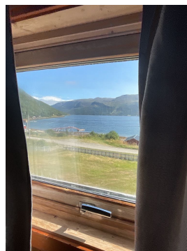
Punktert vindu på soverom nærmest stue kjøkken.
