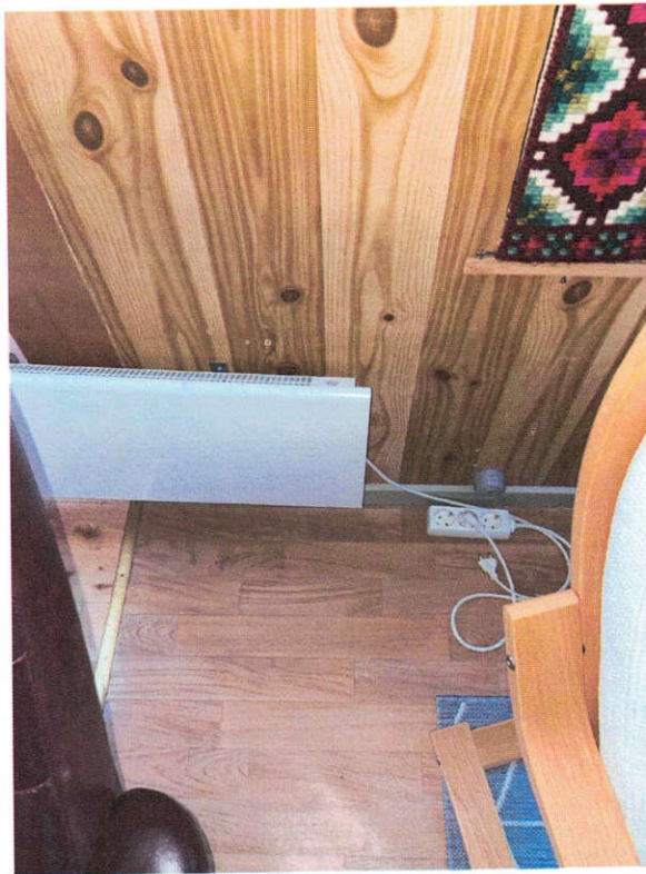
Skjema: "36 NELFO Per. kontr. Bolig NEK405-2: Elkontroll" Spørsmål: Kabler, ledninger og bevegelige ledninger Beskrivelse: Panelovn i stue står i skjøteledning, Filnavn: img_0001.jpg
