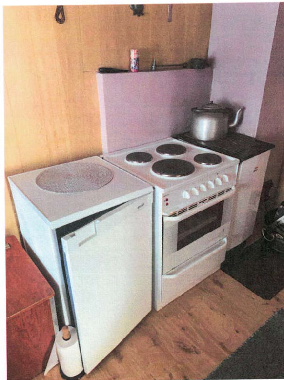
Skjema: "36 NELFO Per. kontr. Bolig NEK405-2: Elkontroll" Spørsmål: Jording av stikkontakter og utstyr Beskrivelse: Mangler jordingsforbindelse til komfyr og kjøleskap, Filnavn: img_0001.jpg
