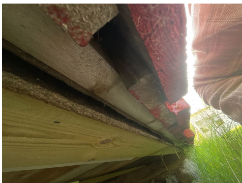
Det er luftespalte bak om kledning men ingen musebånd.
