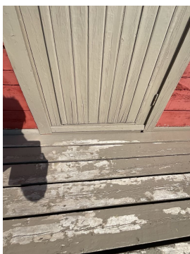
Balkong dør har sprekt treverk.
