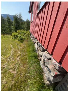
Panel på langvegg buler utover, der man ser at panelen er montert over natursteinen.
