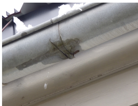
Lekkasje i eldste takrenne
