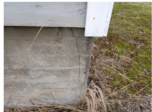
Mindre sprekk ved hjørne mot sørøst
