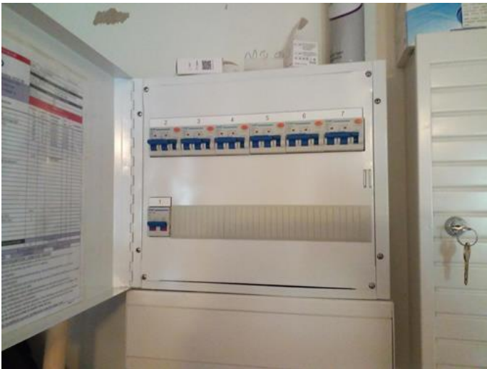
Elektrisk anlegg - [Sikringskap]
