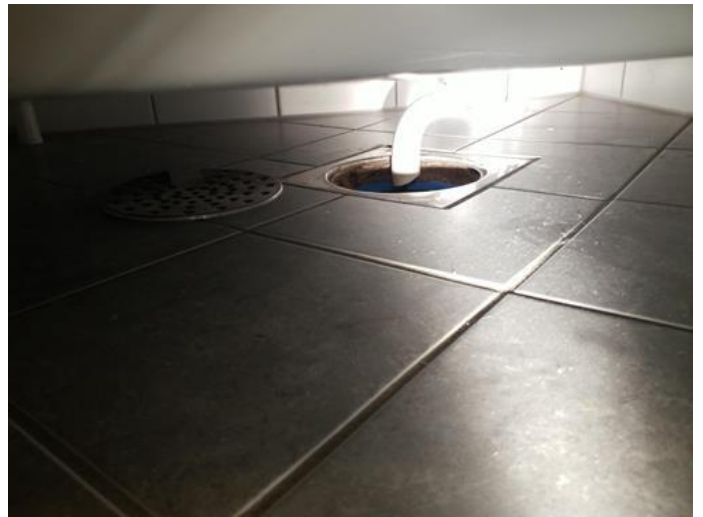
Avløpsrør (ink. sluk) - [Sluk bad]
