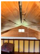
tore ned bøyninger i møne grunnet manglende limtre.
