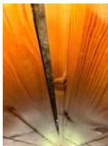
Det mangler plast i møne, fare for skjult svik/kondens.
