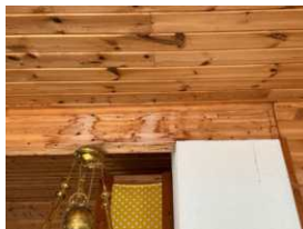
Det ble registrert fukt merker rundt og ved pipe stokken, dette var tørt på befaringsdagen
