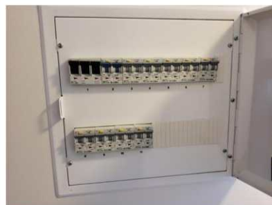
Elektrisk anlegg - [Sikringsskap]
