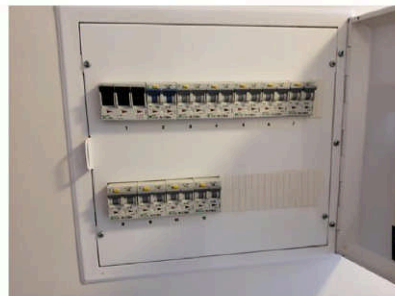
Elektrisk anlegg - [Sikringsskap]
