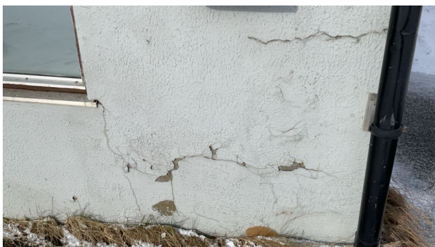
Eksempel på riss/sprekker i mur.
