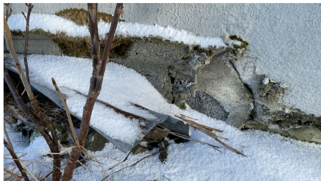
Stedvis er det utsiging av masser under grunnmuren.
