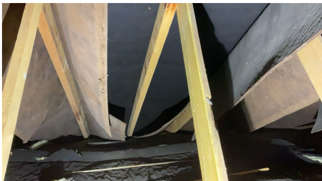
Eksempel på undertaksplater som er falt ned.
