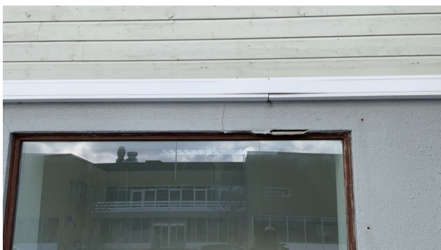
Eksempel på riss/sprekker i mur.
