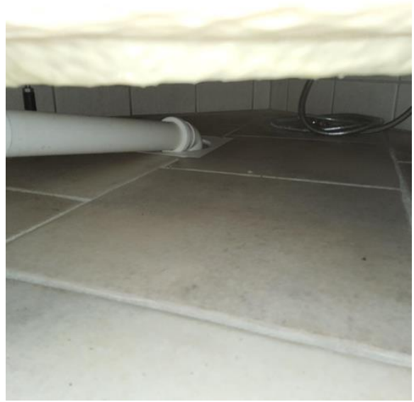
Våtrom - [Sluk under badekar bad 2.etasje ]
