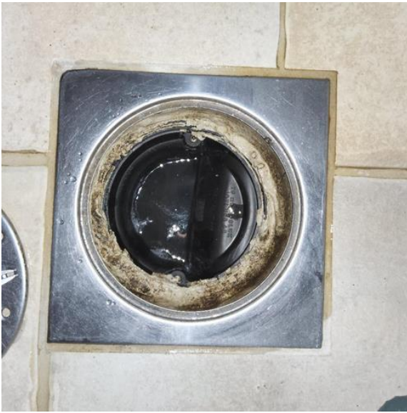
Våtrom - [Sluk dusjsonen bad 2.etasje ]
