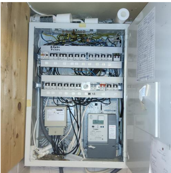
Elektrisk anlegg - [Sikringskapp og kursoversikt]
