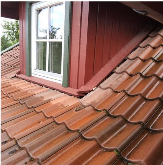
Utvendig - [Eksempel på manglende tetting]
