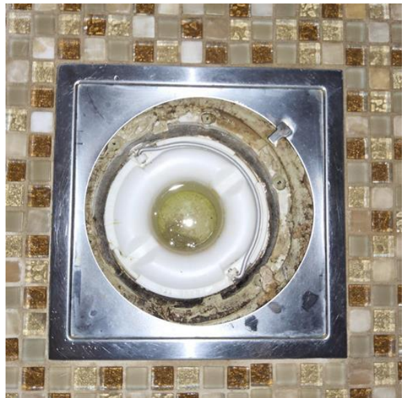
Avløpsrør (ink. sluk) - [Sluk bad 1.etasje ]
