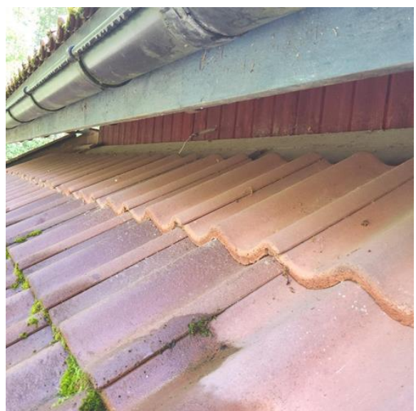
Utvendig - [Eksempel på manglende tetting på tak over bod]
