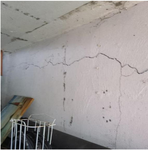
Utvendig - [Eksempel på sprekker i bod]
