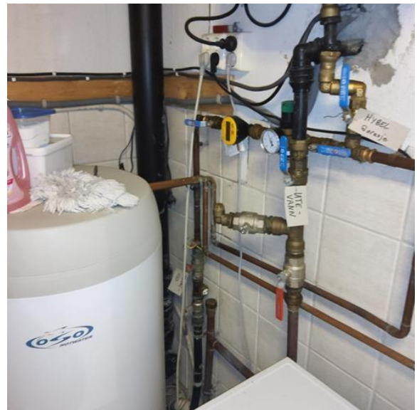
Innvendig - [Varmtvannsbereder, rørpropp og hovedstoppekraner]
