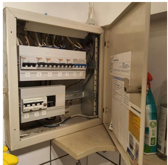
Elektrisk anlegg - [Sikringskapp og kursoversikt plassert i leilighet i garasje]
