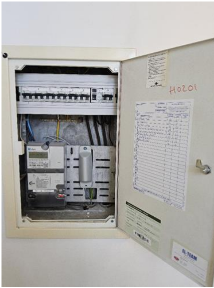
Elektrisk anlegg - [Sikringskap. ]
