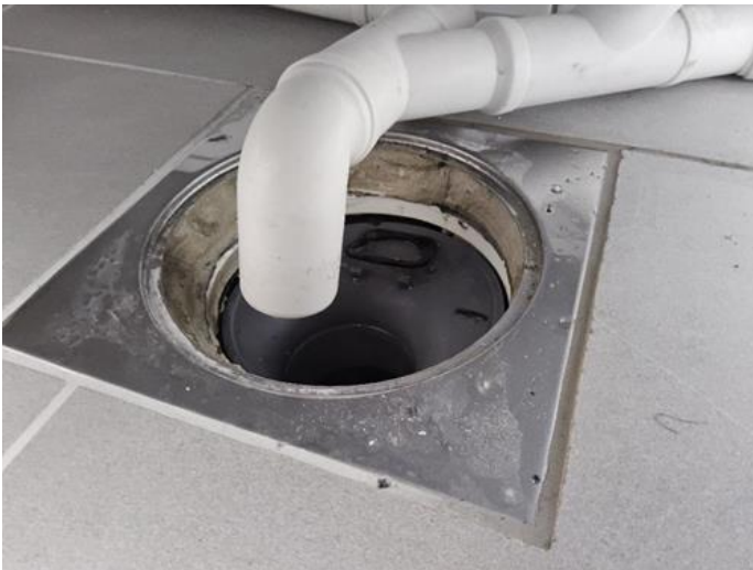
Våtrom - [Sluk på bad.]
