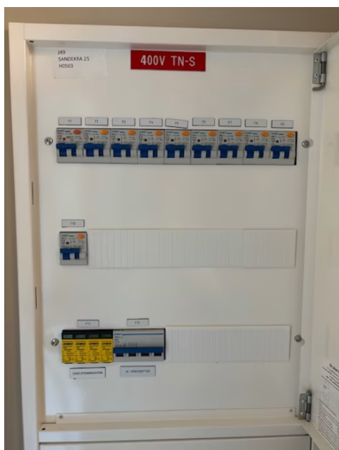
Sikringsskap med automatsikringer plassert i bod/Walk in closet
