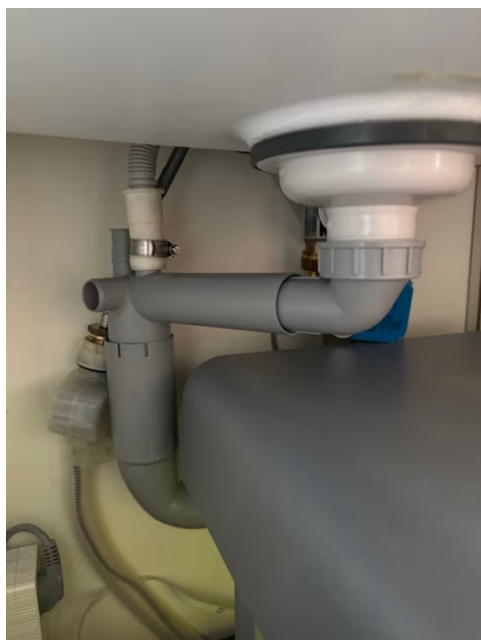
Avløpsrør i underskap vask på kjøkkenet.
