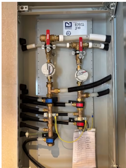
Rørfordelerskap med stoppekran og vannmålere.
