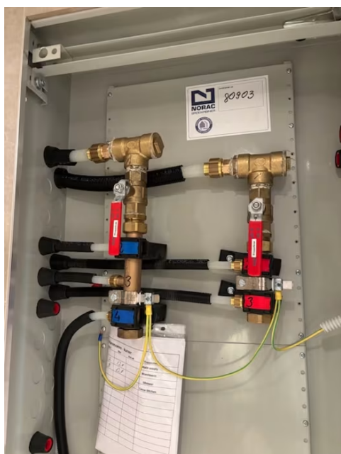
Rørfordelerskap plassert i bad.
