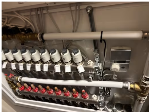
Rørfordelingskap til vannbåren varme plassert i bod/walk in closet.
