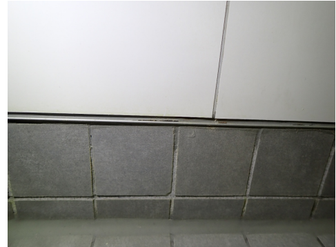
Glipper i fuger i dusjen
