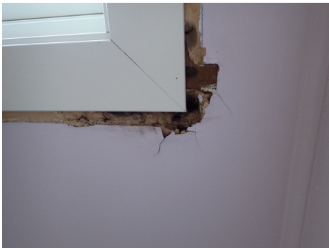
Eksempel på merker/skader rundt vindu
