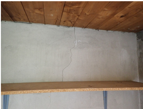
Eksempel på sprekk i mur (bod mot sørøst)
