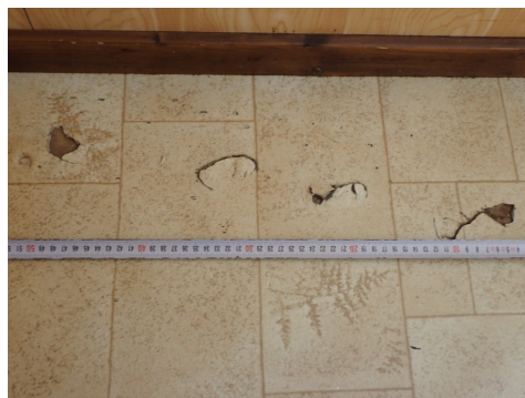
Skade i belegg, kjøkken
