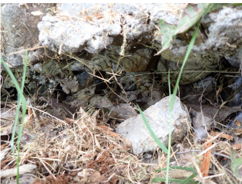
Sig/utvasking under mur mot øst, kun tørrmurt stein synlig
