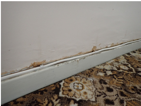
Eksempel på andre skader/merker i vegg
