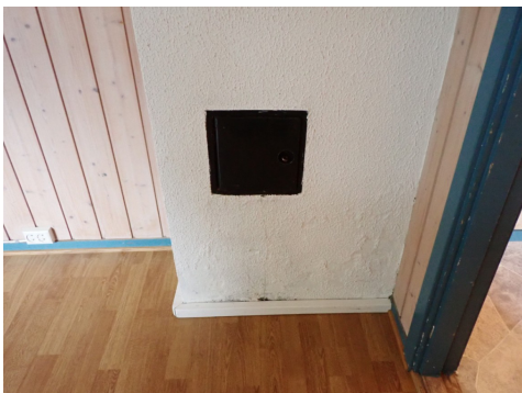
Sotluke, ubrennbar plate under mangler
