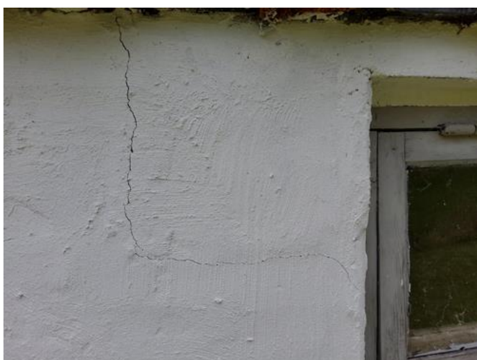
Grunnmur, fundamenter - [Eksempel på sprekk i grunnmur/murpuss]
