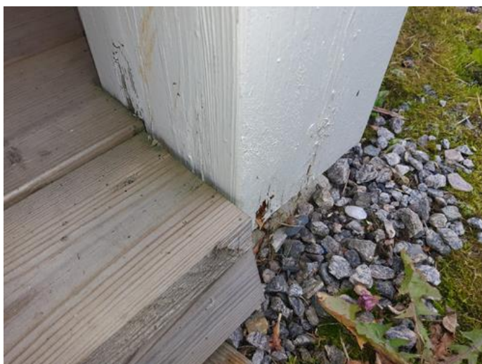
Platting på terreng - [Råteskader]
