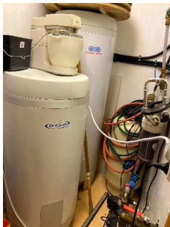
VVB, renseanlegg og rør i rør opplegg, pumpe på gulvet.
