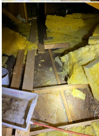
Isolasjon er stedvis borte og der ble registrert muselort
