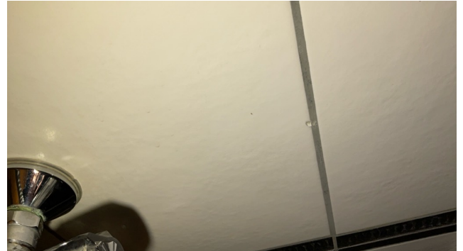
Liten skade på flis og fuge i dusj.
