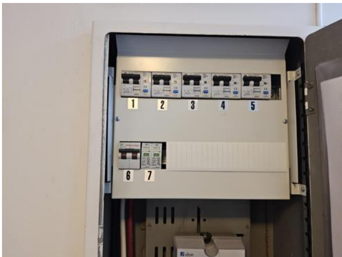
Elektrisk anlegg - [Sikringsskap]
