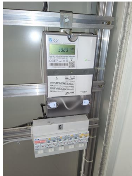
Elektrisk anlegg - [Sikringsskap]
