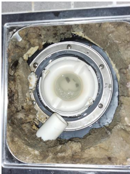
Våtrom - [Sluk bad]
