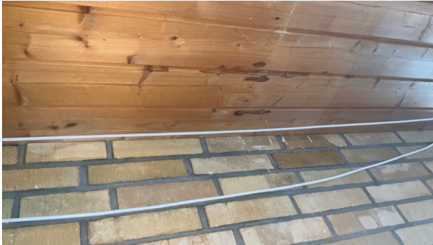
påvist fuktskjolder i tak ved pipe 2. etasje leilighet
