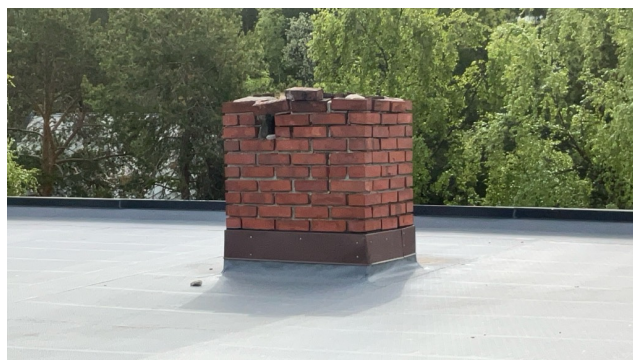
pipe er delvis ødelagt over tak, må utbedres
