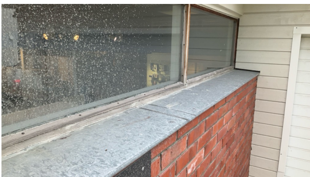
vinduer butikk i dårlig stand
