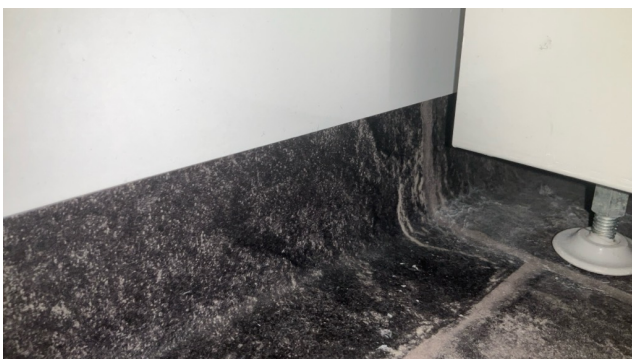
overgang vegg golv, mangler monteringslist i våtsoner
