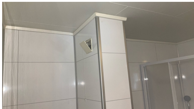
ventil i sjakt
