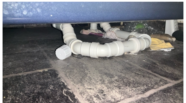
ikke målt fram til sluk som ligger under kabinett
