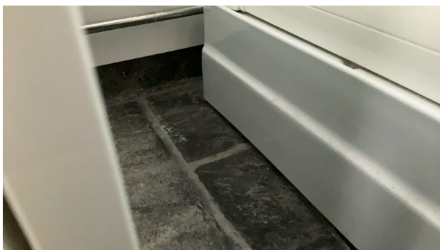
mangler monteringskinne i nedkant av veggplater i våtsoner
