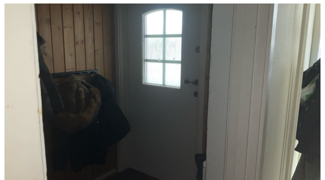
ytterdør entre leilighet 2. etasje, slitt
