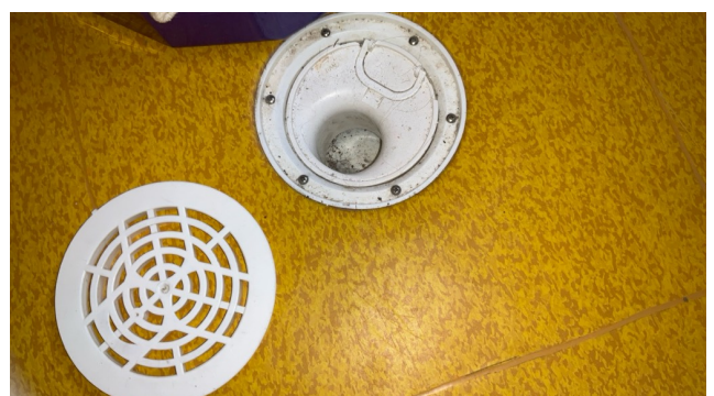
sluk, noe sprekker i i beleggskjøter
