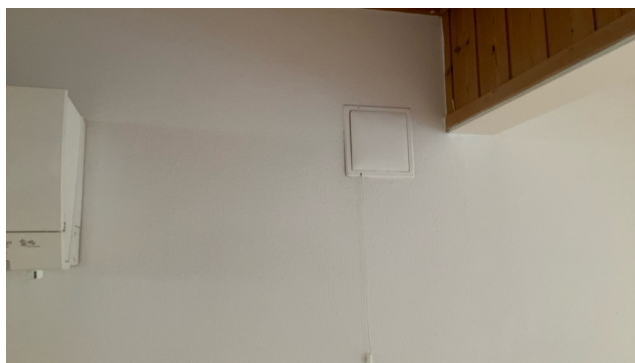
ventiler i vegg
