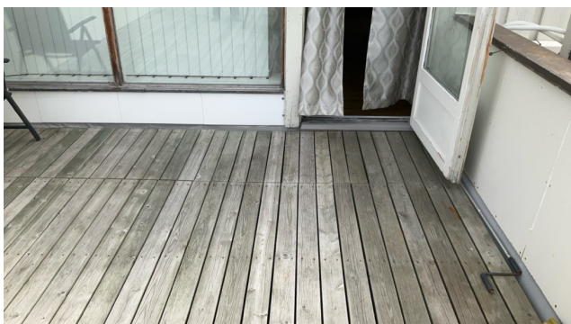
terrassedekke til takterrasse, slitt
