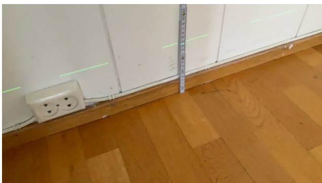
påvist høydeforskjell på golv stue leilighet 2. etasje
