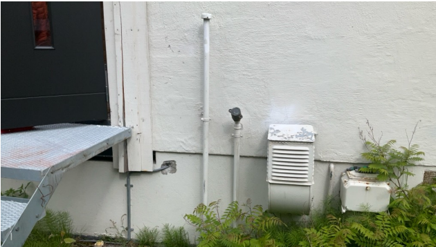
oljetank påfylling og lufting
