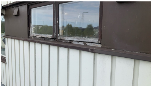
vinduer må skiftes vaskerom leilighet 2. etasje
