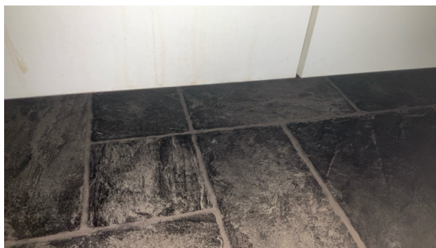
noe slitasje på innredning
