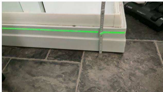
sluk under kabinett, ingen fall til kabinett
