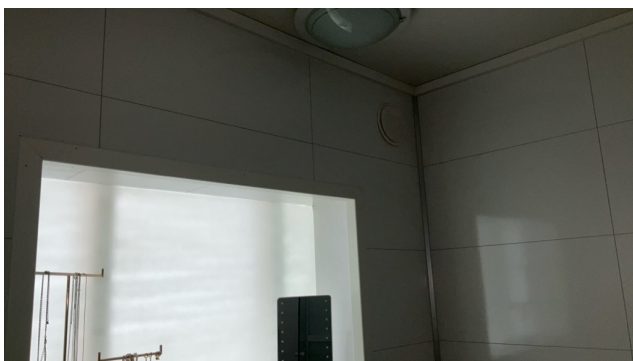
ventil på vegg
