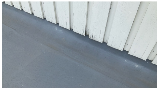
trekledning har noe sprekker i nedkant
