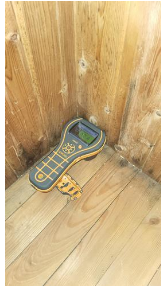
Overflater vegger - [Fuktmerker i garderobe/bod]
