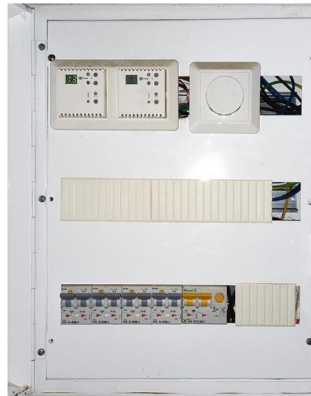
Forenklet vurdering av det elektriske anlegget - [Sikringskap i fjøs]
