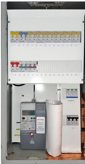
Forenklet vurdering av det elektriske anlegget - [Sikringskap i bolig]
