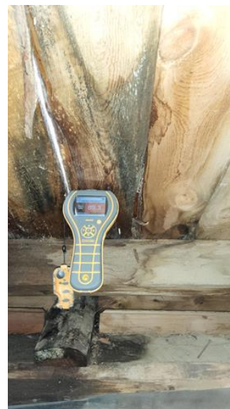
Frittstående byggverk - [Råteskader og fuktmåling i taktro i fjøs]
