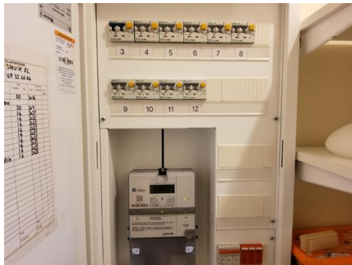
Elektrisk anlegg - [Sikringskap]
