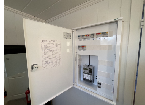
Sikringsskap med automatsikringer
