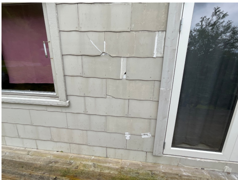
Synlig sprekkdannelse i kledning
