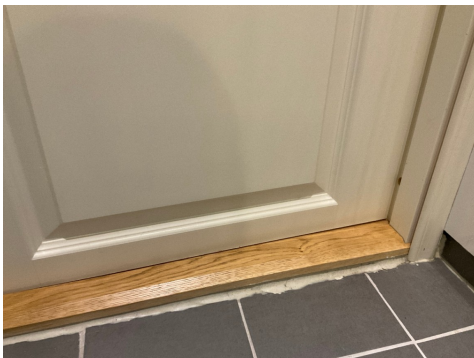
Ingen tilluft ved dør.
