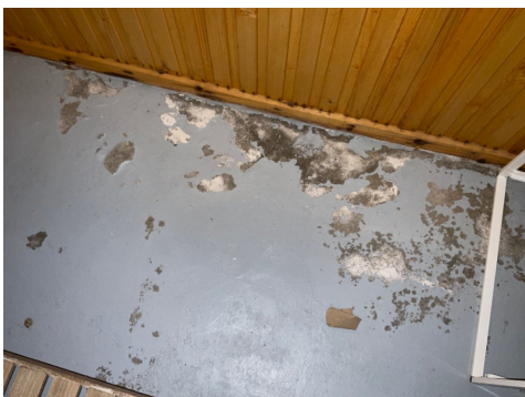
Saltutslag i gulv, bod. Det er også høye fuktverdier måt i vegg.
