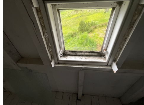
Råteskadet vindu i kvist,
