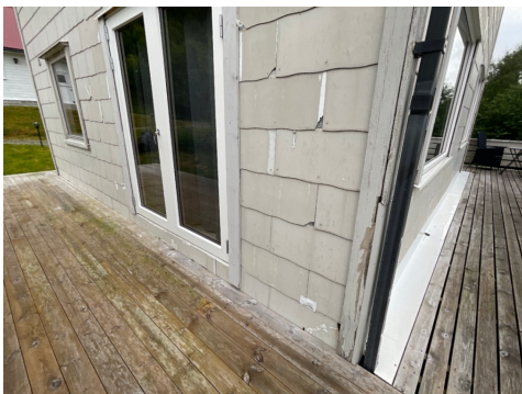
Synlig skader i kledning.
