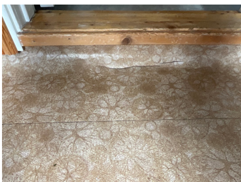
Defekt belegg ved dør.
