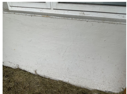
Sprekk under vindu, vegg mot vest.
