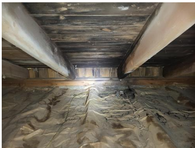
Loft - uinnredet / råloft - [Loft, mørke partier på loft over lufting til kloakk]
