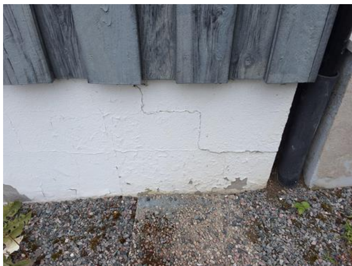
Grunnmur, fundamenter - [Stedvis riss/sprekker i grunnmur]
