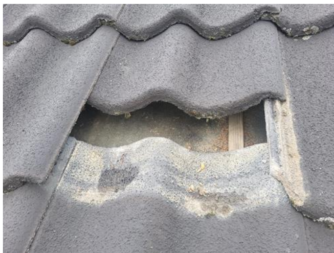
Yttertak - [Yttertak, undertaket er ikke byttet]
