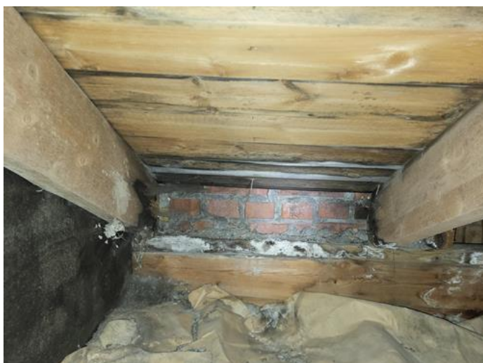
Loft - uinnredet / råloft - [Loft, fuktmerker ved pipe]
