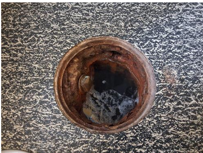
Våtrom - [Sluk på bad]
