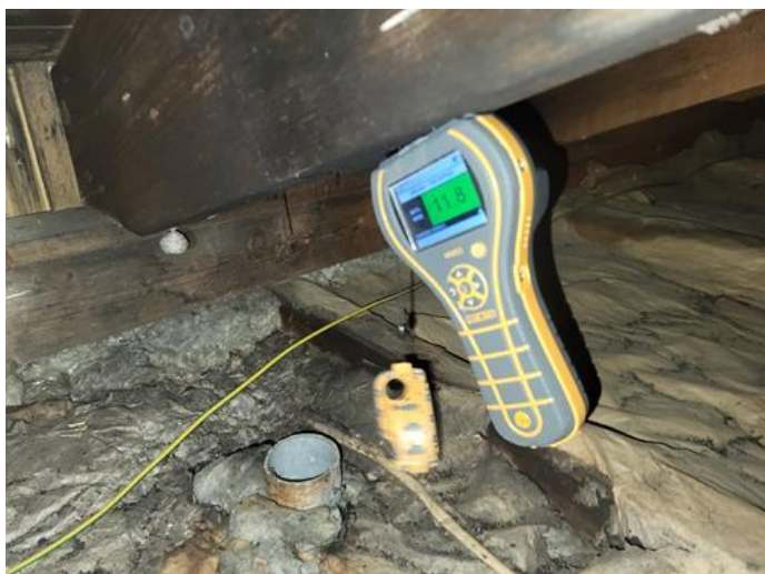
Loft - uinnredet / råloft - [Loft, mørkepartier/svertesopp over lufting til kloakk, ikke målt forhøyede verdier]
