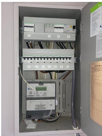
Elektrisk anlegg - [Sikringskap 2]
