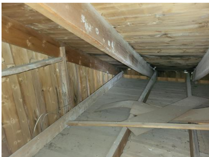
Loft - uinnredet / råloft - [Loft, stedvis fuktmerker i undertaket]
