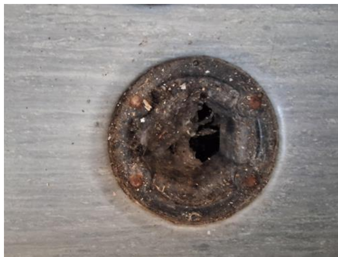
Våtrom - [Sluk vaskerom]
