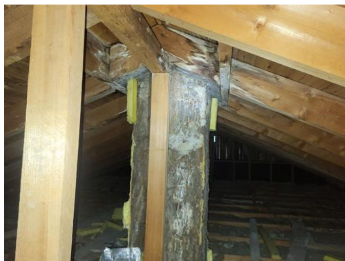
Loft - uinnredet / råloft - [Loft, pipe i møne, fuktmerker]
