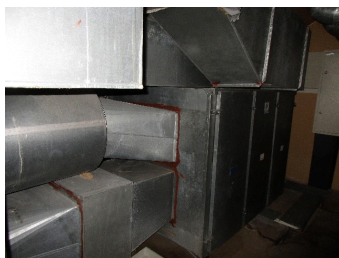
Ventilasjonsrom i 2. etasje
