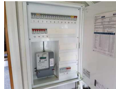
Elektrisk anlegg - [Sikringskap]
