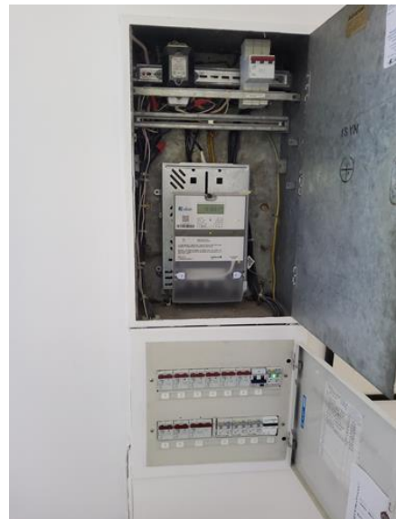
Elektrisk anlegg - [Sikringskap ]
